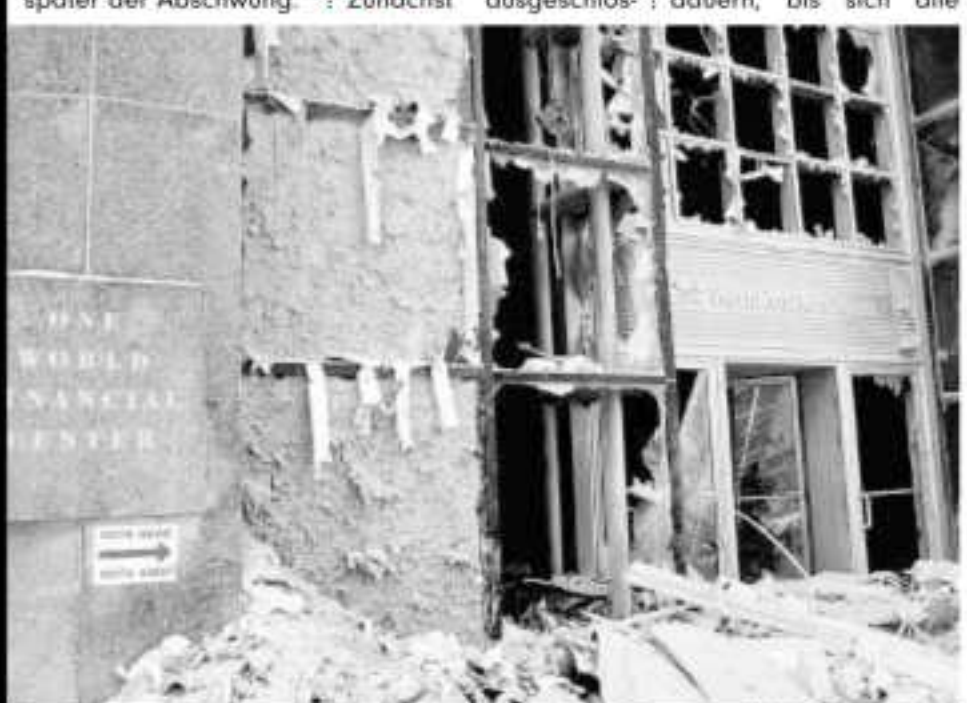
Die völlig zerstörte Fassade eines der eingestürzten Türme des World Trade Center. Das Gebäude war das Symbol für Freihandel und Wohlstand. Foto: SIPA PRESS
